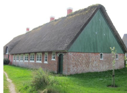
I nordsiden ses døren ind til stalden samt de to små støbejernsvinduer i gavlen.
